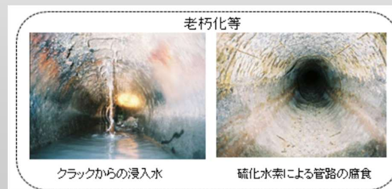
老朽化した管渠の様子（出典：国土交通省）
