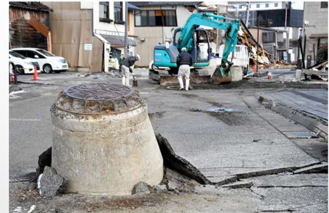
液状化によるマンホールの浮上（出典：朝日新聞社）
